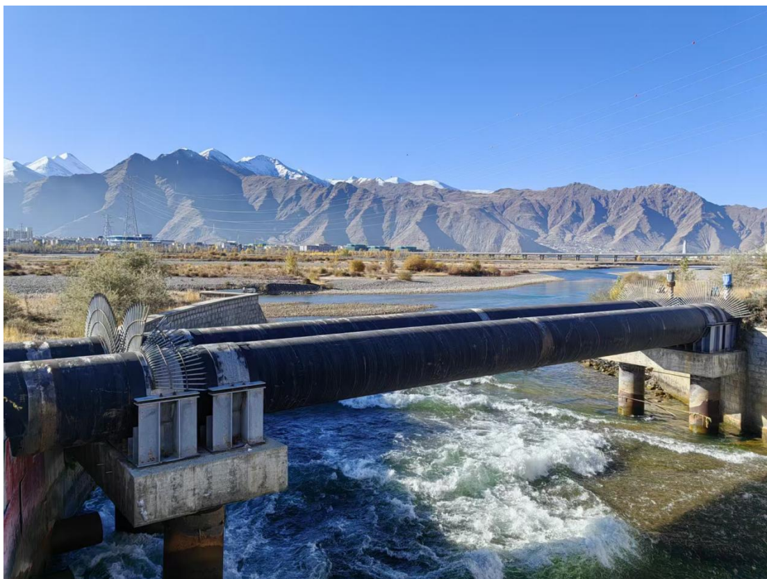
图 1.7-1 纳金自来水厂主输水管照片
